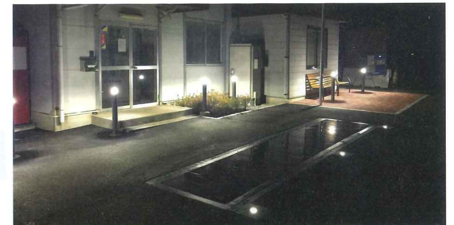
資料6 ■ 埋設した太陽光パネルで昼間に発電した電気を蓄電池に充電し、周辺の照明に活用している様子(写真:日本道路)
