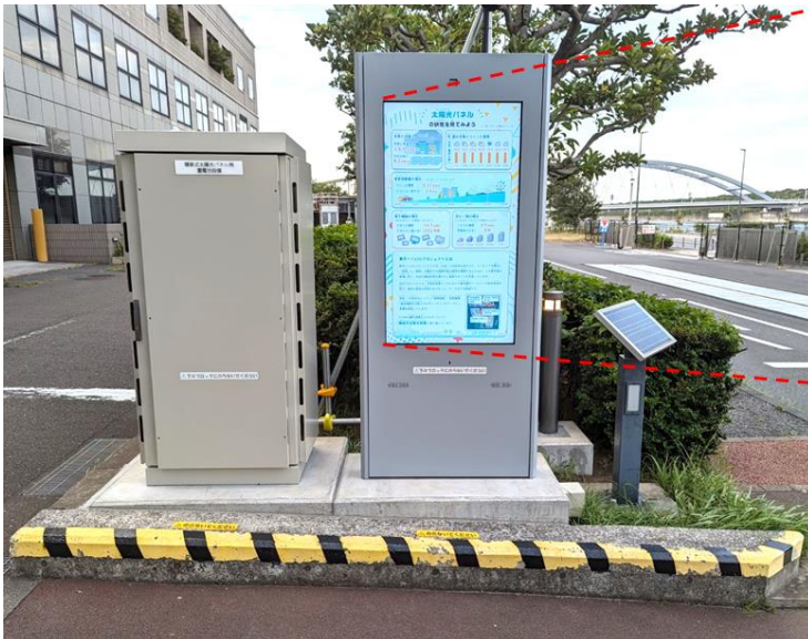
デジタルサイネージ設置状況
